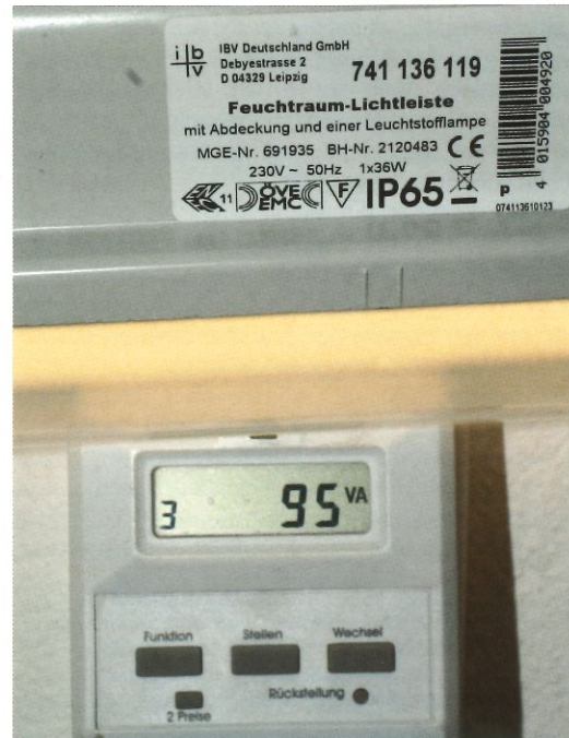
Feuchtraumlichtleiste mit konventioneller Drossel: Der angegebene Verbrauch von 36 Watt/h wird durch die Drossel, das mechanische Vorschaltgerät, auf 95 Watt/h gesteigert.
