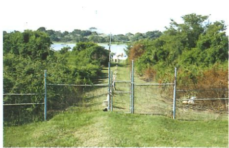
Die Pumpstation für Frischwasser oberhalb der Lagune.
